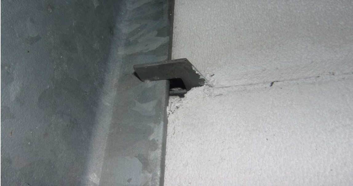
Photo n°03 – Absence d'assemblage fusible en file 8'
