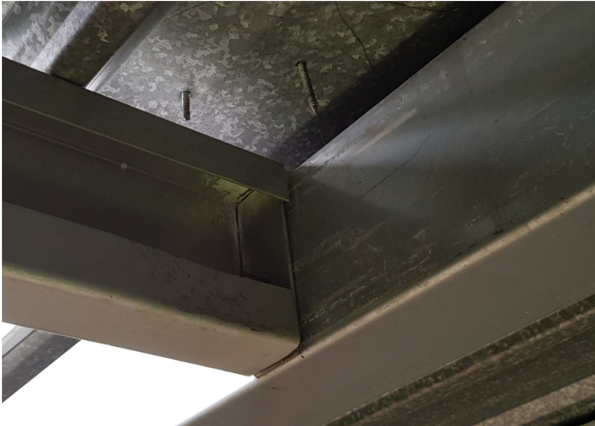
Photo n°11 – Absence de liaison des chevêtres de skydom
