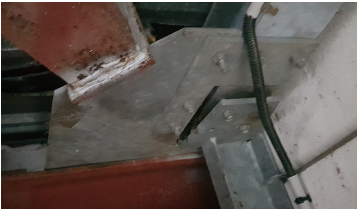
Photo n°04 – Reprise aléatoire de l'assemblage lors de la construction du mur coupe feu entre la zone 1 et 2
