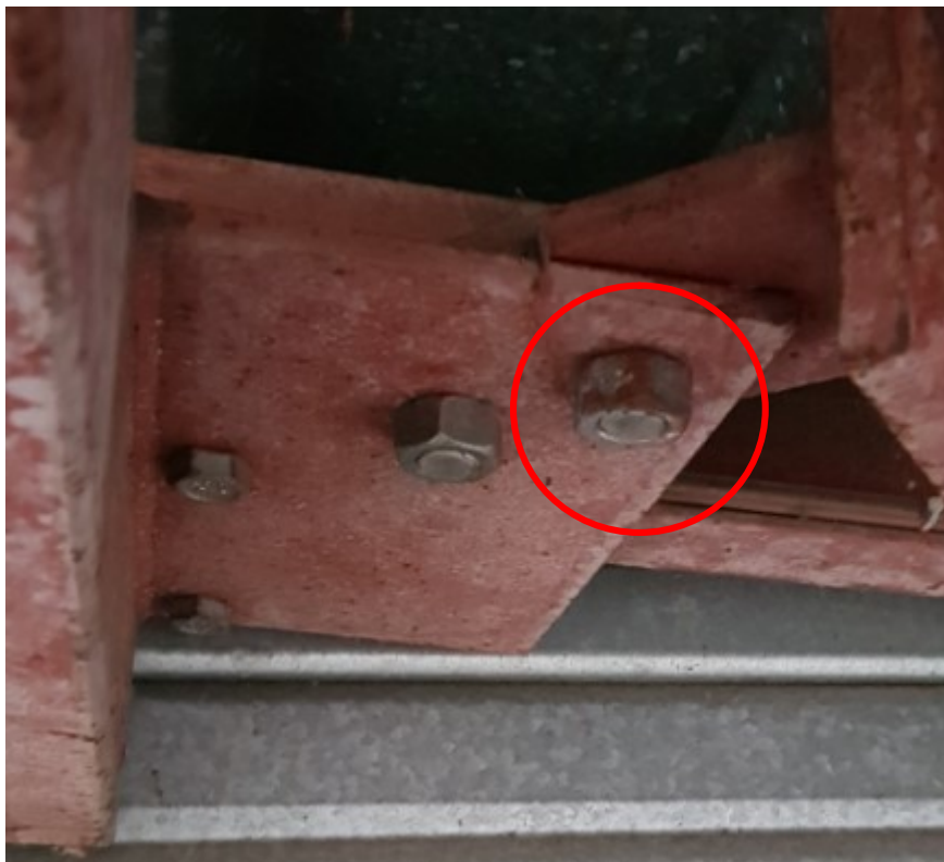
Photo n°10 – Longueur de boulon non conforme
