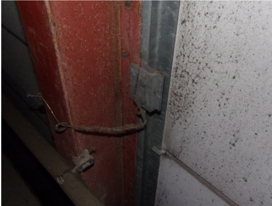
Photo n°01 – Absence de fixation fusible du mur coupe feu file 8
