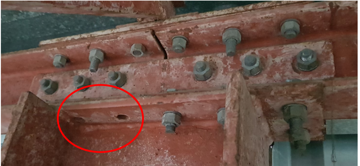
Photo n°11 – Absence de 2 fois 2 boulons dans l'assemblage du joint de transport des Mh10 en file C
