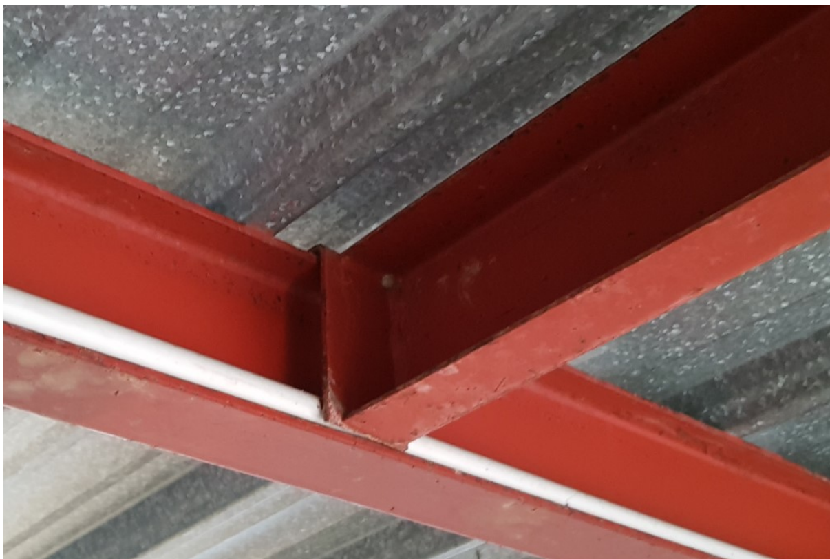
Photo n°08 – Absence de liaison des chevêtres de skydom
