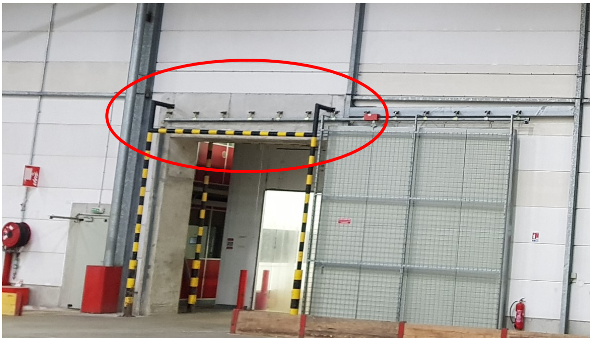
Photo n°07 – Absence d'une barre Bm80 en file 8'
