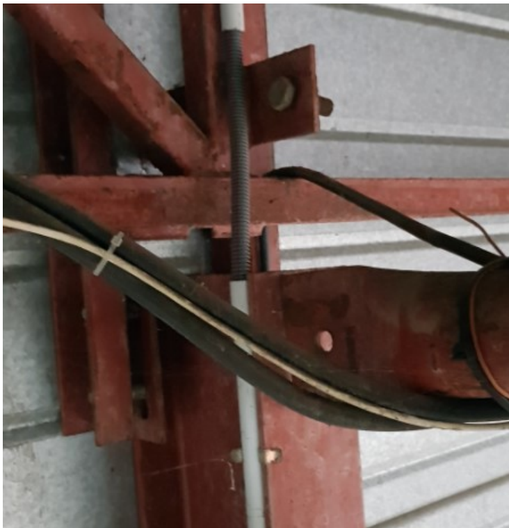
Photo n°09 – Absence de liaison du système d'antiflambement en file 11
