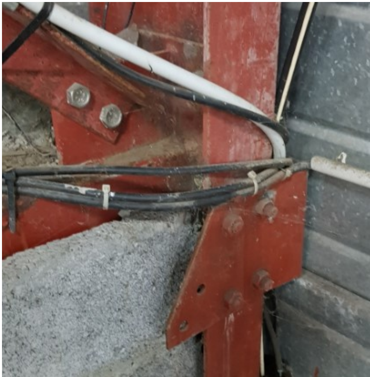
Photo n°06 – Absence de la diagonale Cm90 de la palée de stabilité file A
